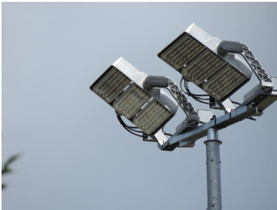
Bild 5: Flutlichtmast, 2x LED-Strahler
