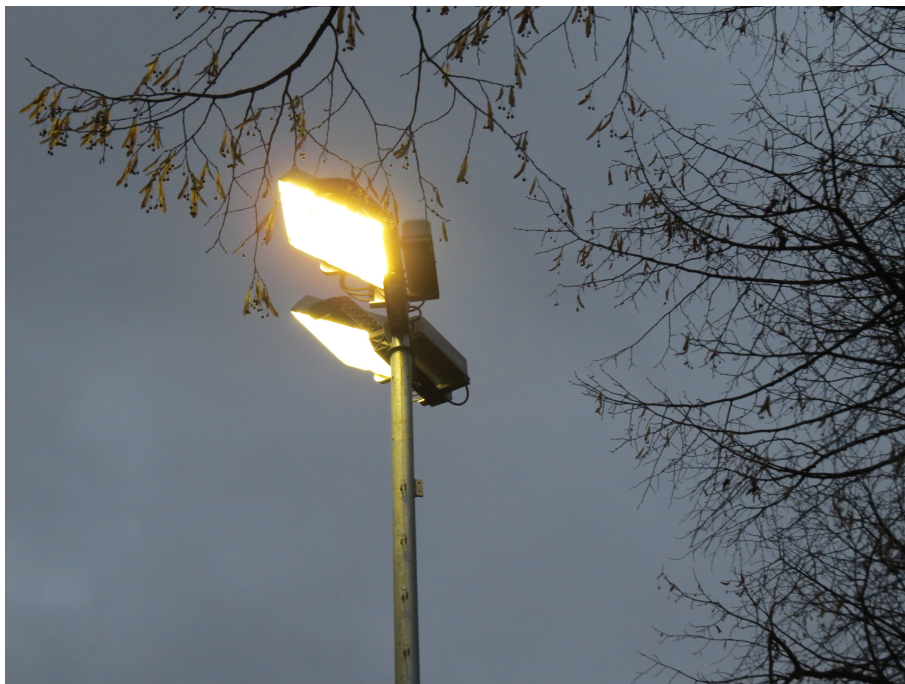
Bild 7: Flutlichtmast, 2x LED-Strahler, abends
