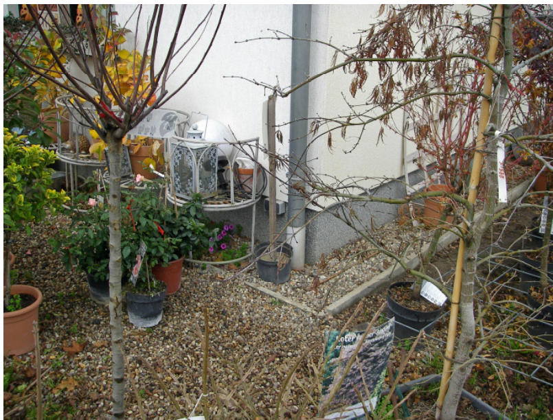
Abb. 20: Direkteinleitung der Dachflächenentwässerung in eine Rohrrigole, hier die Südostecke des Büro- und Sozialgebäudes. (Foto RIK: P1010020.JPG)
