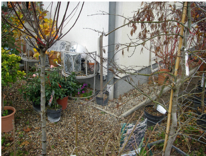
Abb. 18: Direkteinleitung der Dachflächenentwässerung in eine Rohrrigole, hier die Südostecke des Büro- und Sozialgebäudes. (Foto RIK: P1010020.JPG)
