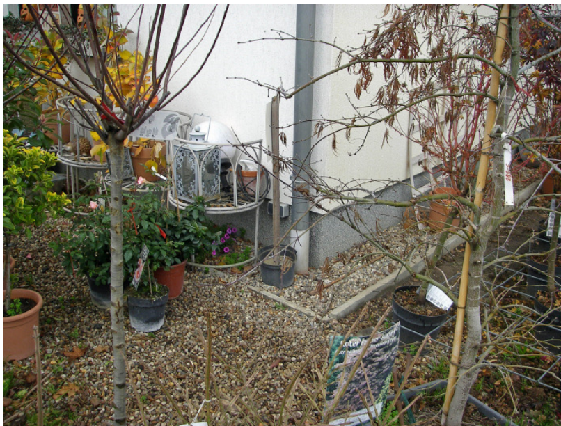
Abb. 20: Direkteinleitung der Dachflächenentwässerung in eine Rohrrigole, hier die Südostecke des Büro- und Sozialgebäudes. (Foto RIK: P1010020.JPG)
